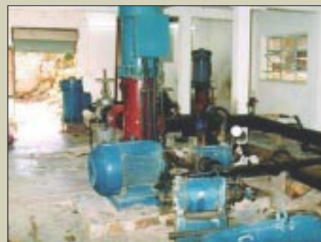
Pumping Station, Ein Samia
