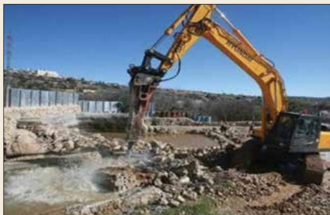
Destruction de puits près d'Hébron
